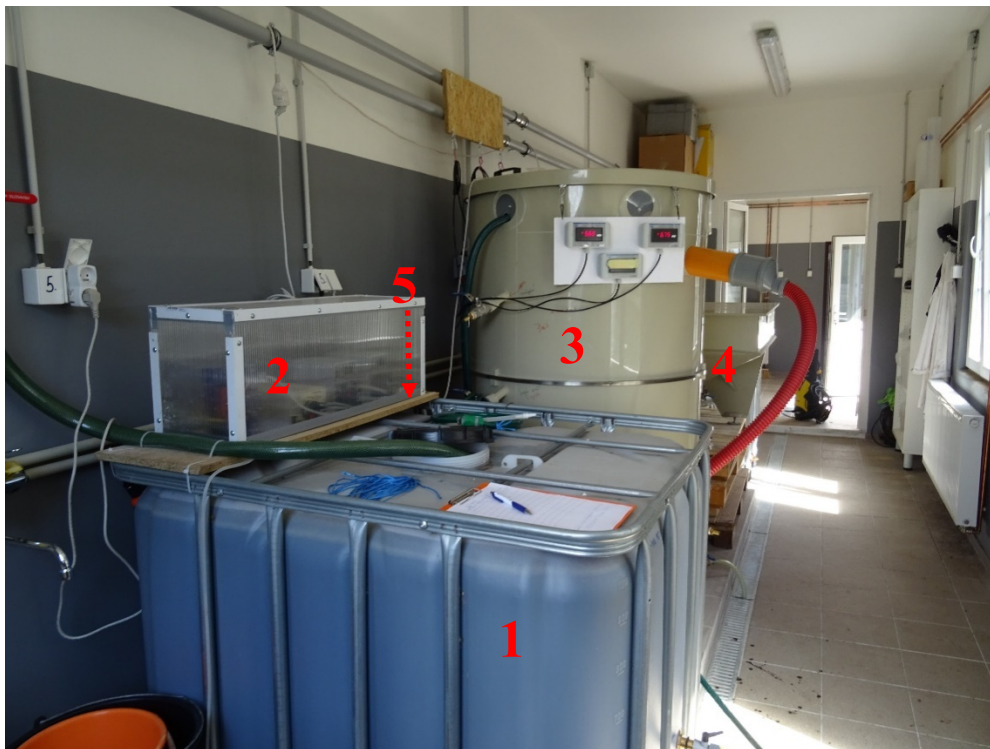
Obrázek 3: Fotografie poloprovozního nitrifikačního reaktoru pro zpracování fugátu (1 – zásobník vstupního fugátu; 2 – čerpadla pro transport fugátu a dalších tekutin; 3 – vlastní nitrifikační reaktor; 4 – dosazovací nádrž; 5 – membránové dmychadlo)
